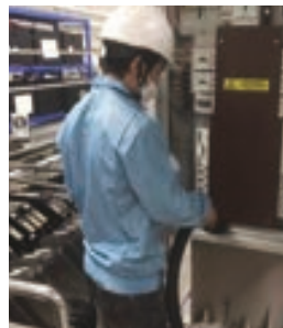
配電系統監測
