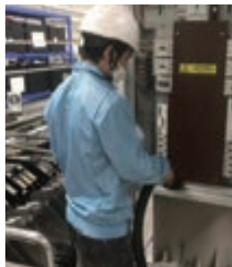
配電系統監測
