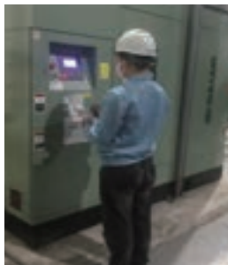
空壓機組監測
